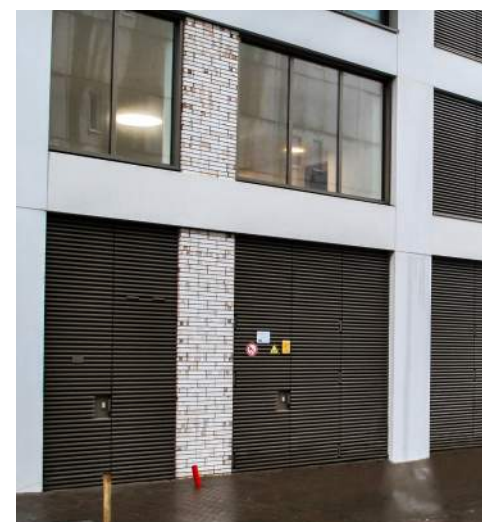
Trafo-deur integraal mee-ontworpen
