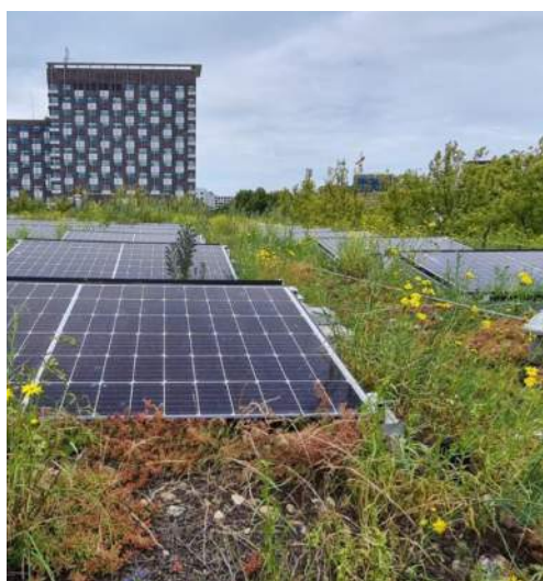
Zonnepanelen met groendak
